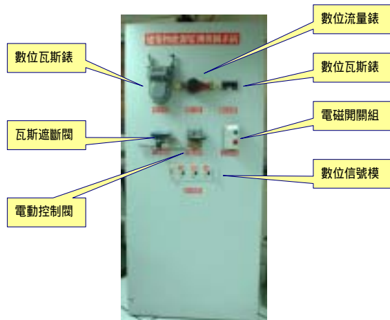
圖 1 建築物能源監測模擬系統完成實體 (2) 硬體設備概述
